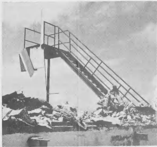
THE STARK outline of a fire escape marks the demise of the Old Zone 2 building. E FIGURA seco di un trapi di candela ta marca e fin di oficina Zone 2.
